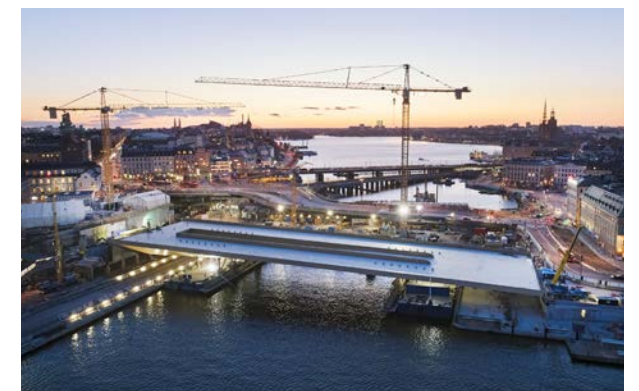
När den guldfärgade huvudbron kom på plats vid nya Slussen i Stockholm krävdes rigorös planering in i minsta detalj.
